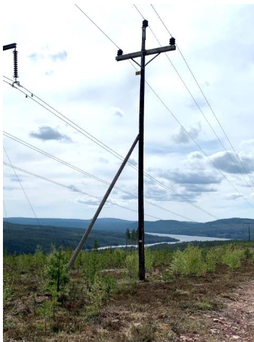
Figur 3. Enkelstolpe tillhörande befintlig 72,5 kV ledning L154. Fasavstånd cirka 1,3 meter.
