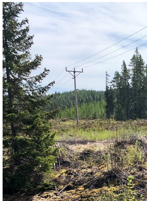
Figur 4. Enkelstolpe tillhörande befintlig 72,5 kV ledning L154. Fasavstånd cirka 2 meter.
