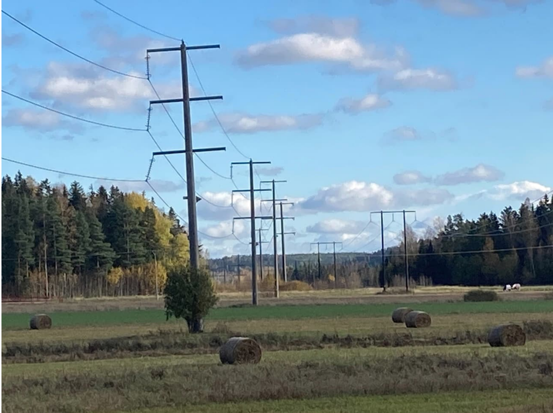
Figur 10. Ledningen i vänstra delen av fotot är L10 där nya ledningen kan sambyggas på befintliga betongstolpar. Ledning OL8 syns till höger i bild.
