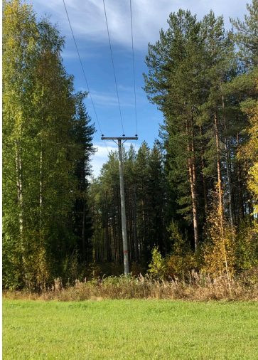
Figur 6. En icke träsäker ledningsgata inom lokalnätet (Bild från Skellefteå Kraft Elnät).
