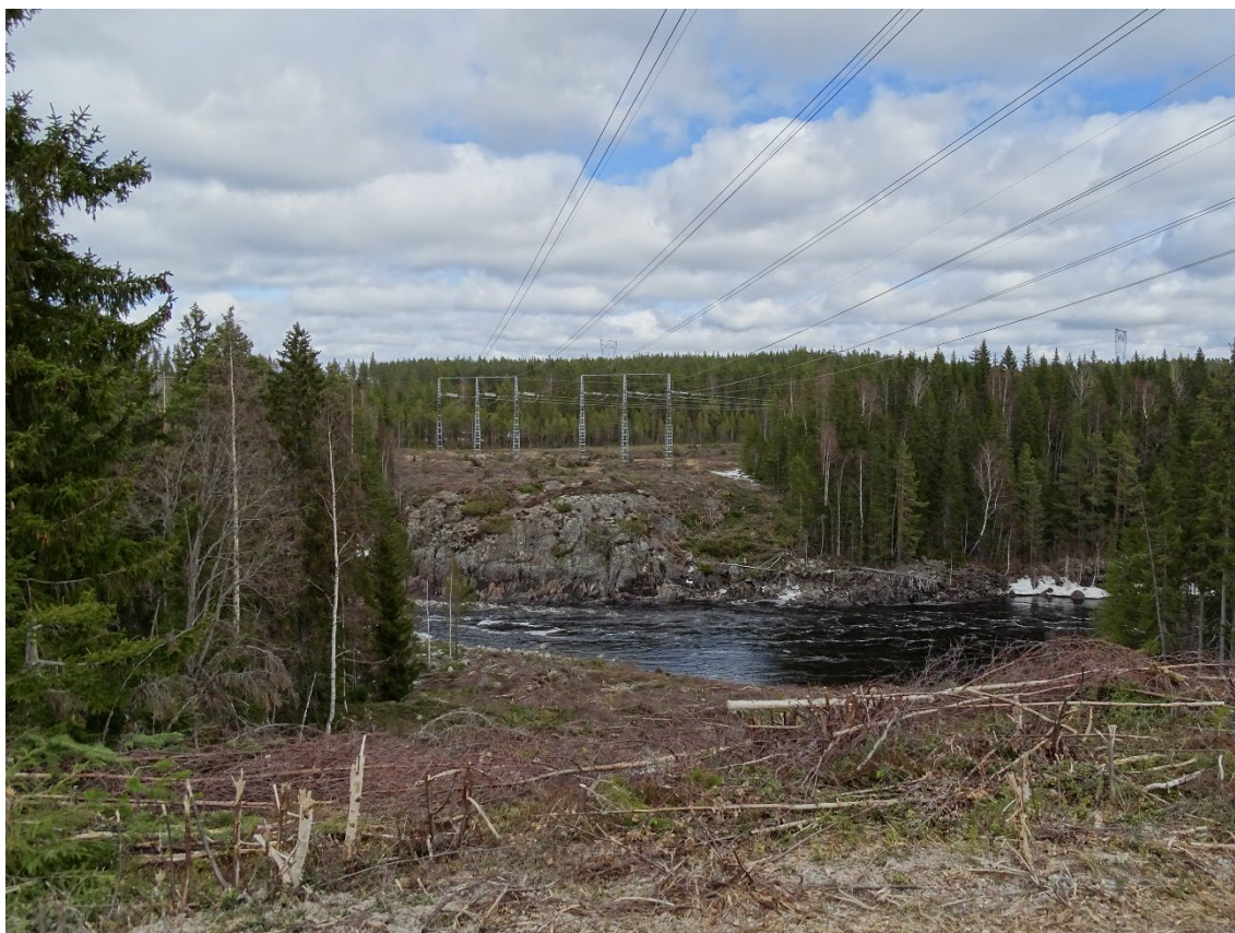
Figur 2. På bilden ses Svenska kraftnäts 220 kV-ledningar (RL7 S2 och RL2 S3) och de långa ledningsspännarna över älven Ljusnan. En av Ellevios nya ledningar är planerad att byggas väster om (vänster i bild) Svenska kraftnäts två befintliga ledningar. Ellevios andra ledning planeras att byggas i Svenska kraftnäts västra ledningsgata (vänstra ledningen i bild) efter att den raseras.
