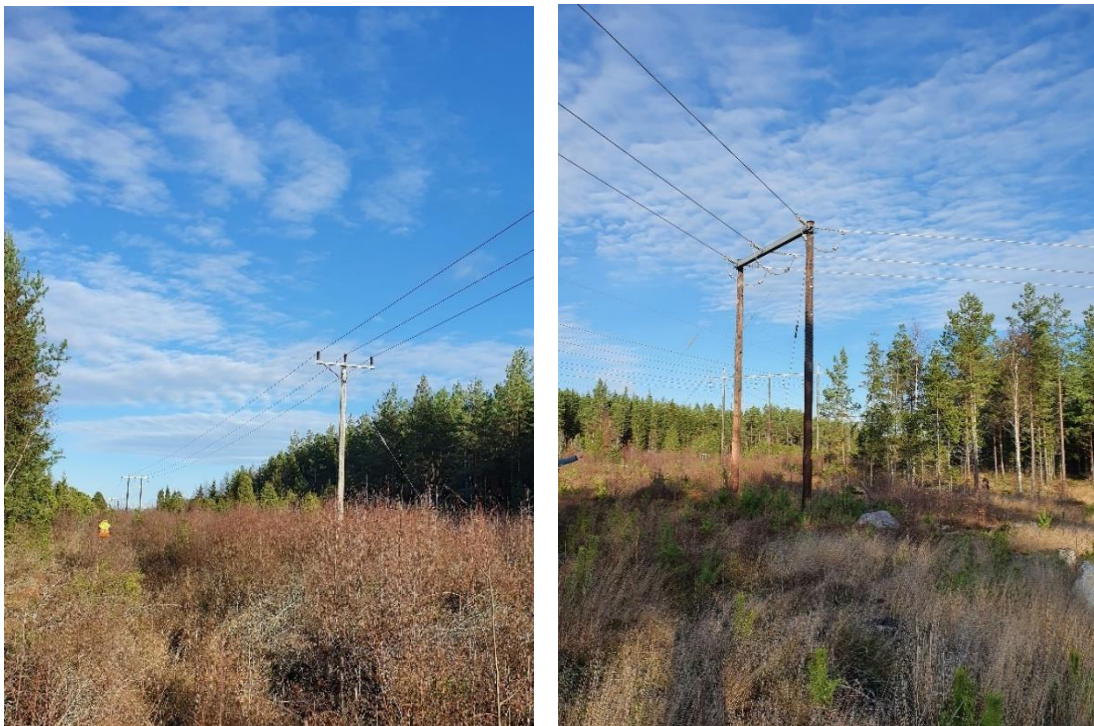
Figur 3, till höger befintlig ledning uppförd på enbent stolpe, i bakgrunden skymtas en portalstolpe. Till vänster befintlig vinkelstolpe som idag står inom detaljplan för Ånsta 20:9 m.fl. fastigheter.
